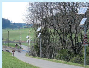
Pour l'éclairage des rues, la cité de l'énergie de Köniz produit son propre courant écologique. Les lampes solaires avec détecteur de mouvement sont indiquées pour l'éclairage de chemins piétons lorsqu'un raccordement au réseau électrique se révèle trop coûteux.
